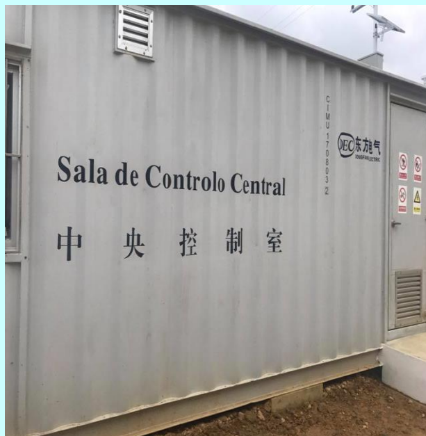
Sala de Controlo Central.
