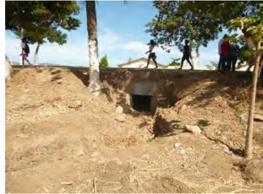
Foto 07 | Vala junto a estrada nº 100
