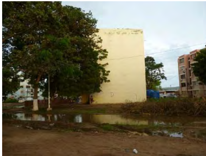
Fotografia 23 – Zonas de águas paradas no E15
