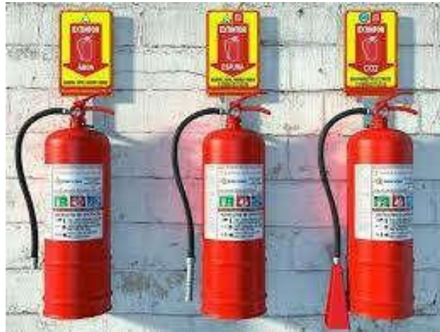
Figura 38 – Exemplo de extintores
