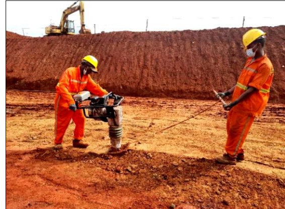
Figura 6. Trabalhadores sem EPIs de protecção auditiva numa das frentes de obrado do subprojecto 8W3A em NDaltando
