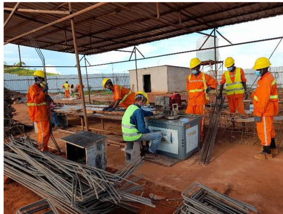
Figura 7. Trabalhadores com EPIs adequados numa actividade de preparação do material de cofragem -frente de obra do subprojecto 8W3A em NDalatando
