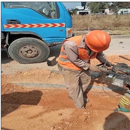
Figura 3. Trabalhador com EPI adequado para operação de compactador - frente de obra do subprojecto 33W3-b em Huambo
