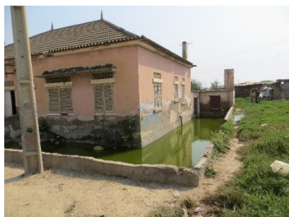
Figura 7.62 – Vista geral de habitação em zona com nível freático muito elevado (vista 1, bairro de São João)
