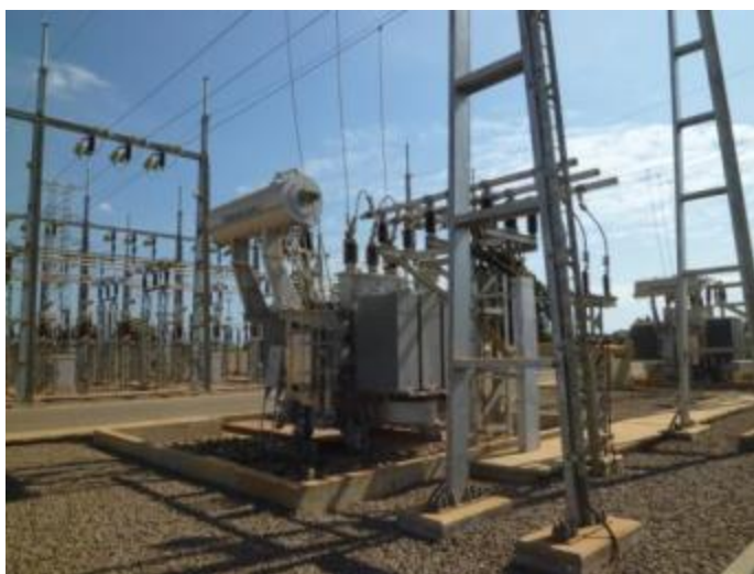
Figura 7-14 Transformador 66 kV/ 15 kV de fabricação chinesa
