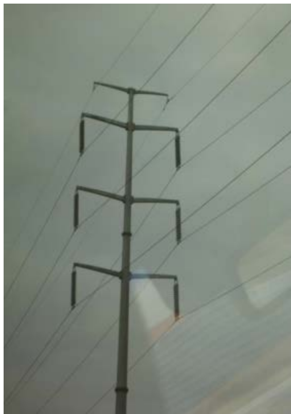
Figura 7-10 Torre de coluna de aço 220 kV (suspensa)
