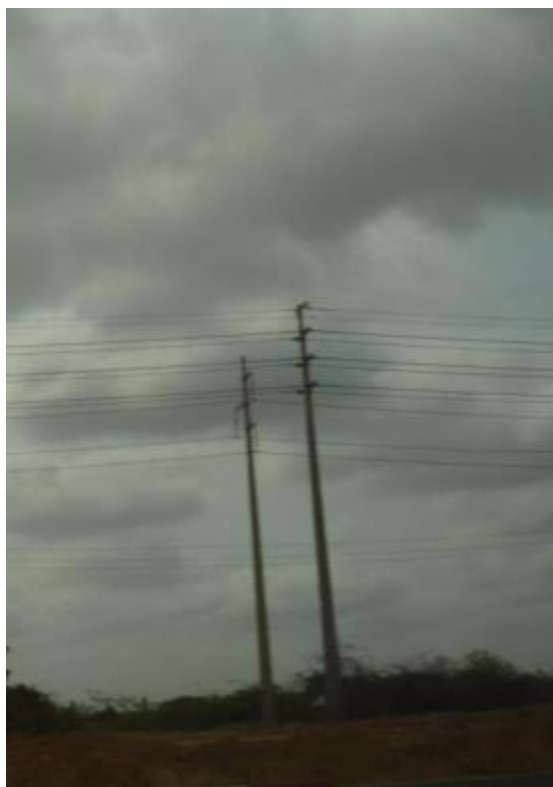
Figura 7-5 Colunas de betão 60 kV
