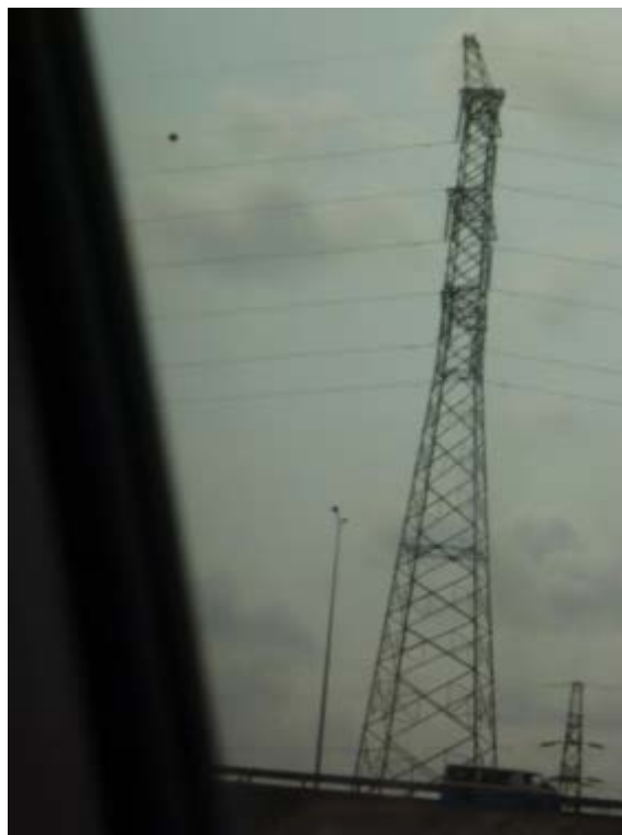
Figura 7-12 Torre de ângulo de aço 220 kV
