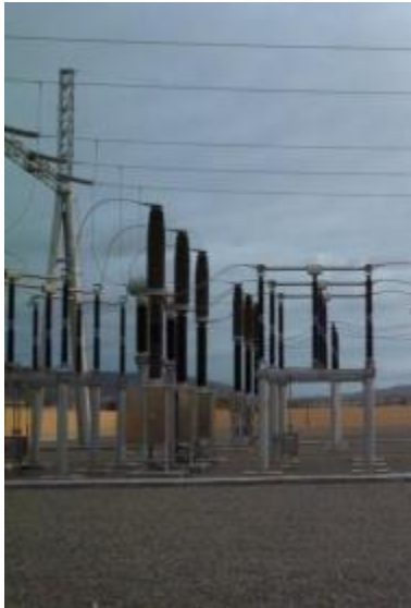
Figura 7-16 Disjuntores verticais a gás 220 kV
