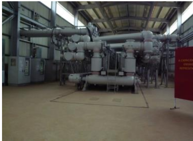
Figura 7-17 Comutador isolado a gás, tipo interior
