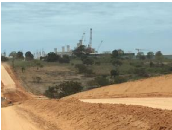
A imagem da central a partir da estrada de acesso (em construção)
