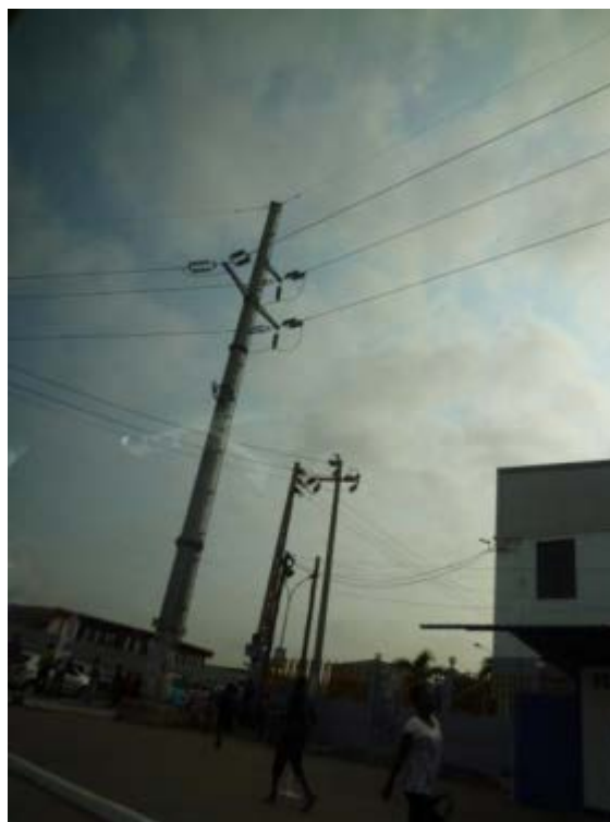
Figura 7-8 Torre de coluna de aço 60 kV
