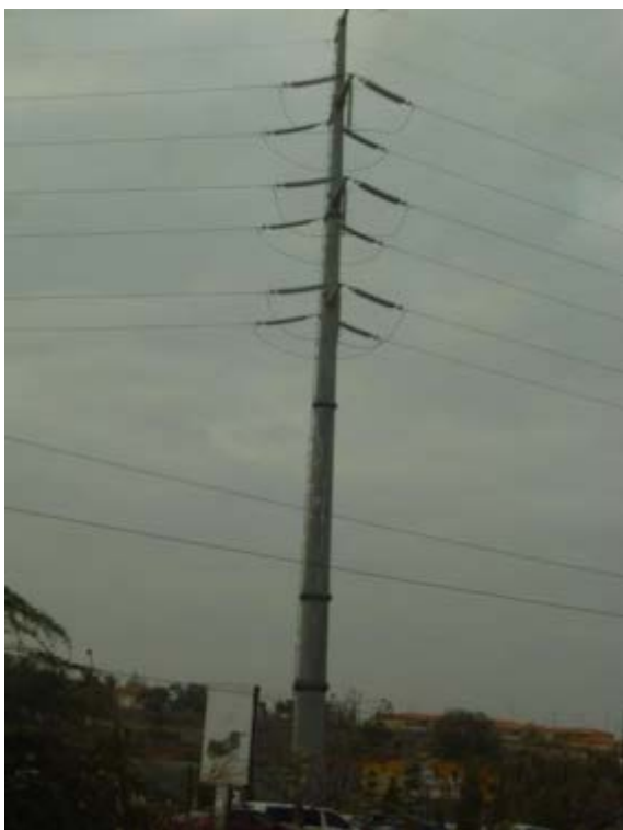
Figura 7-9 Torre de coluna de aço 220 kV (de tensão)
