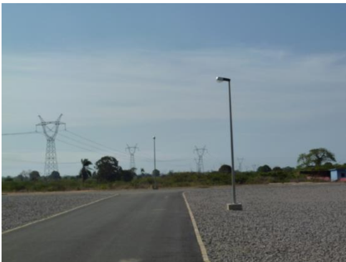
Figura 7-13 Linha (única) de transmissão 400kV (vista geral)
