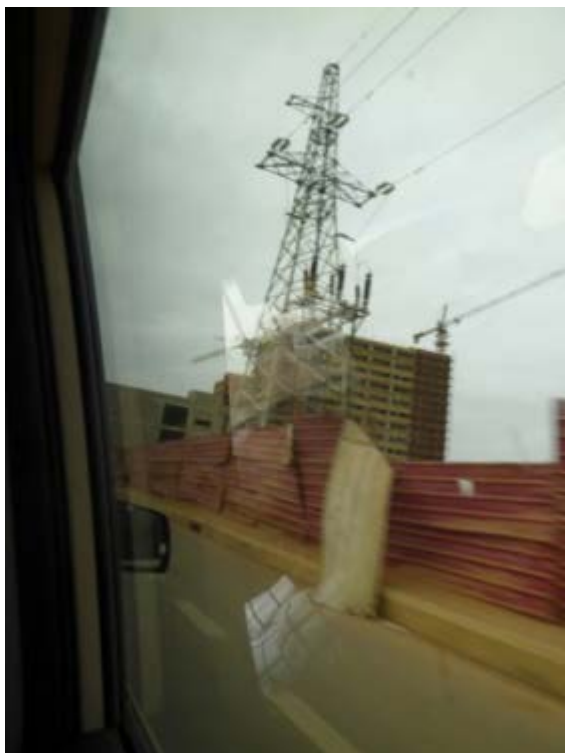
Figura 7-7 Torre de ramificação de linha subterrânea 60 kV
